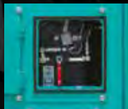
Manuelles Notventil für das Absenken der Kabine
